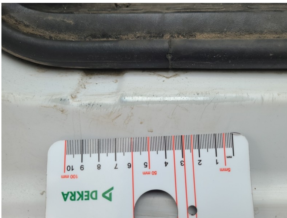
Vid' popis k poškodeniu č. 7
