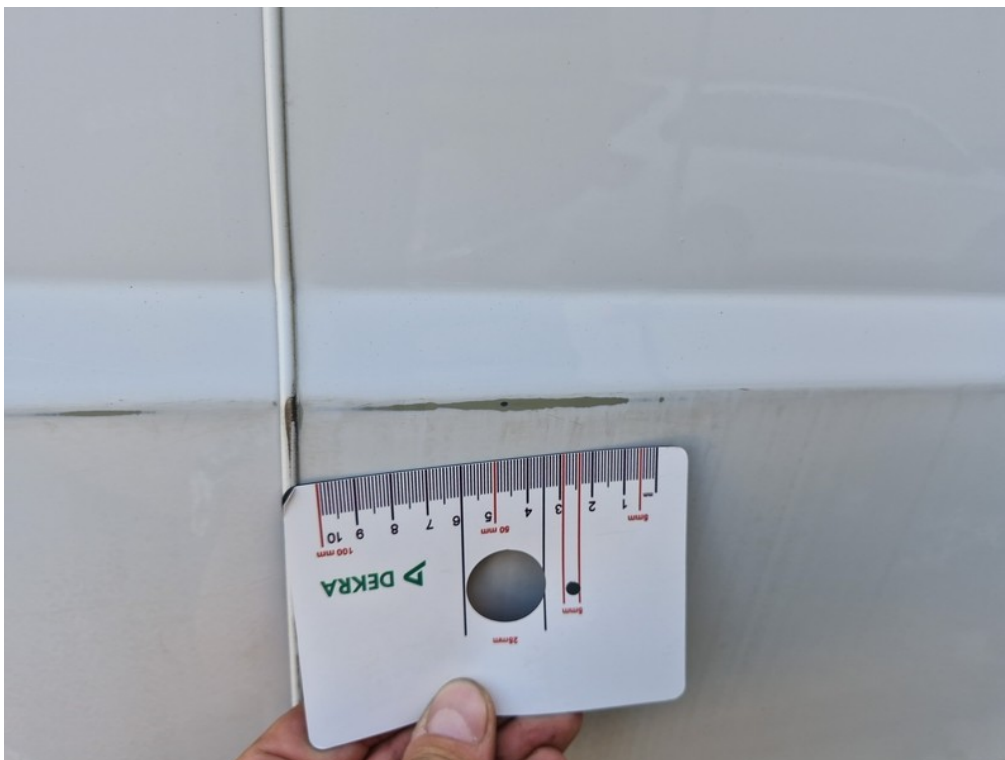
Vid' popis k poškodeniu č. 8
