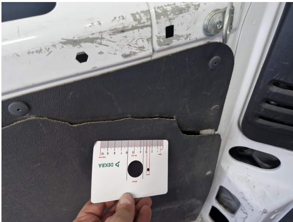
Vid' popis k poškodeniu č. 19
