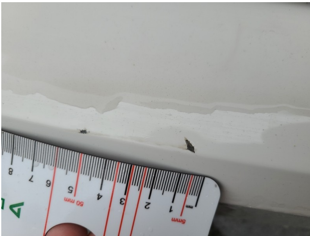
Vid' popis k poškodeniu č. 3
