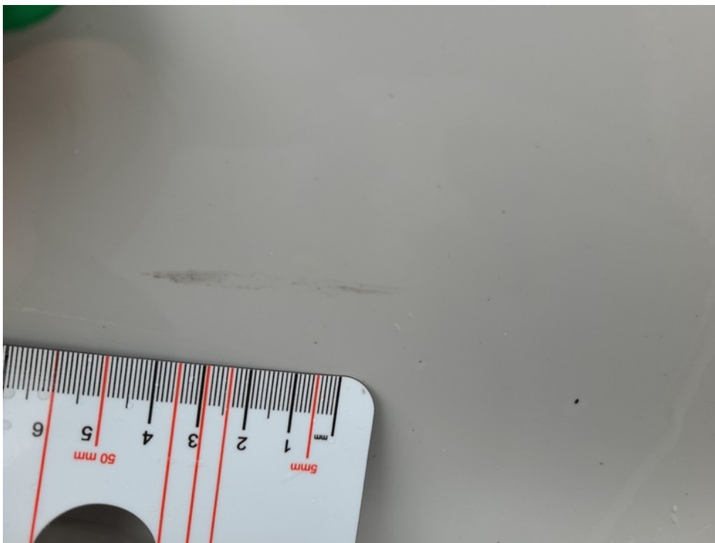
Vid' popis k poškodeniu č. 5
