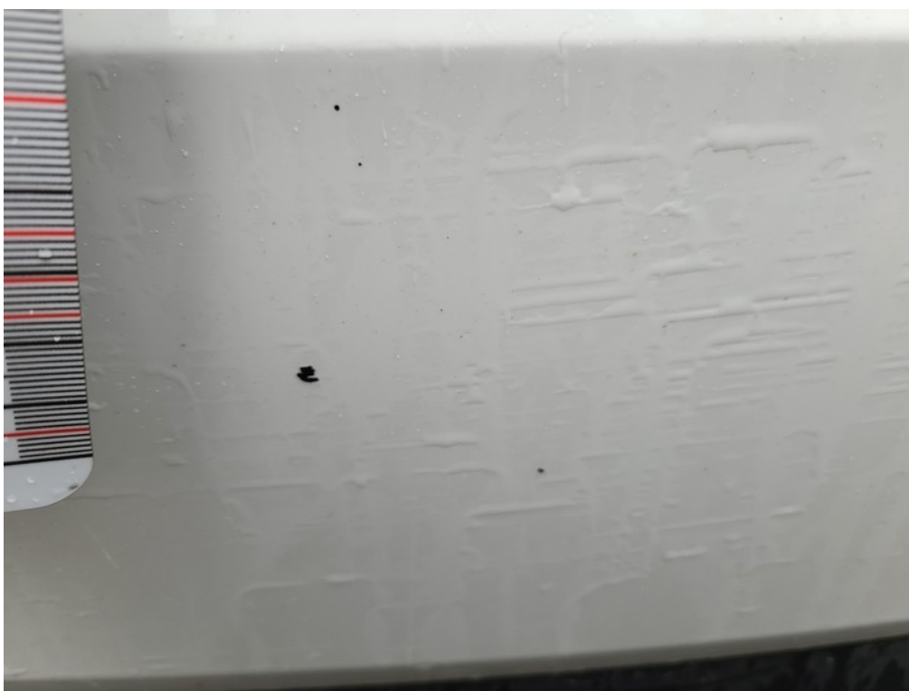
Vid' popis k poškodeniu č. 3
