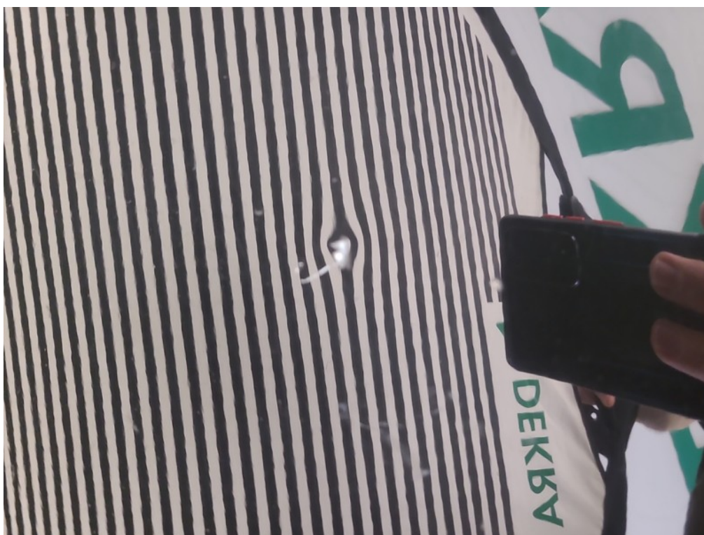
Vid' popis k poškodeniu č. 4
