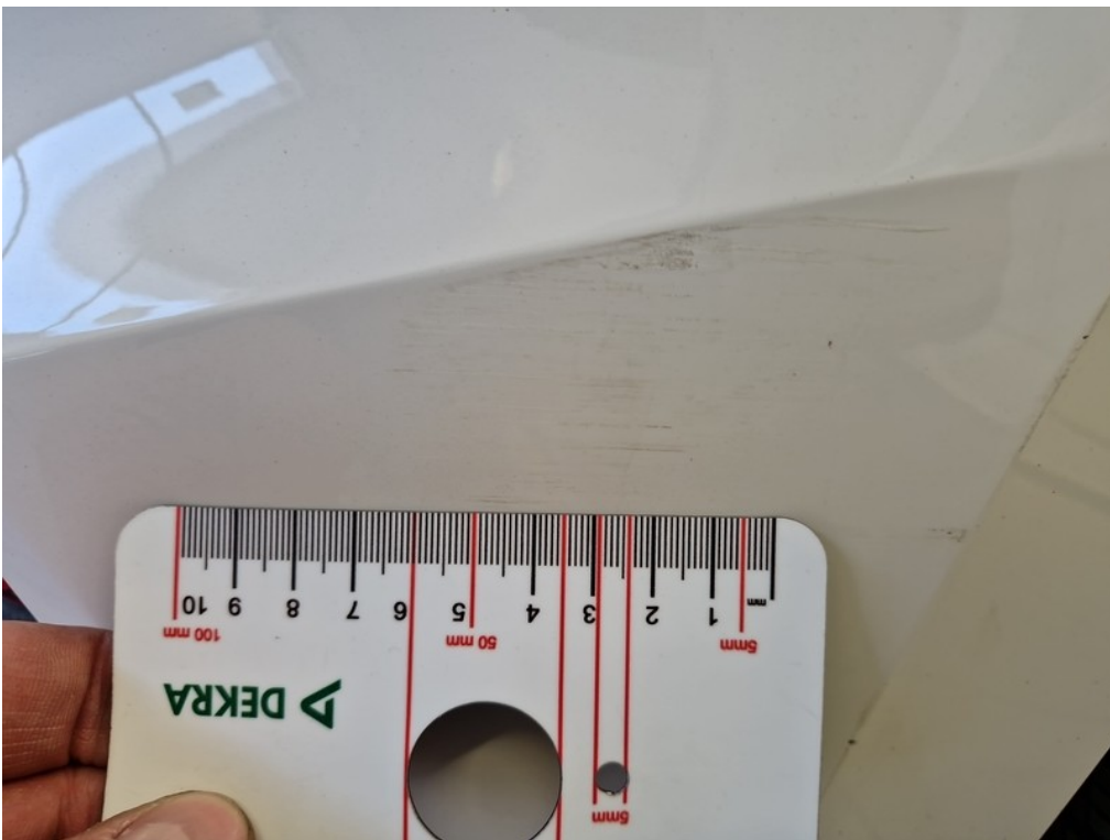
Vid' popis k poškodeniu č. 5
