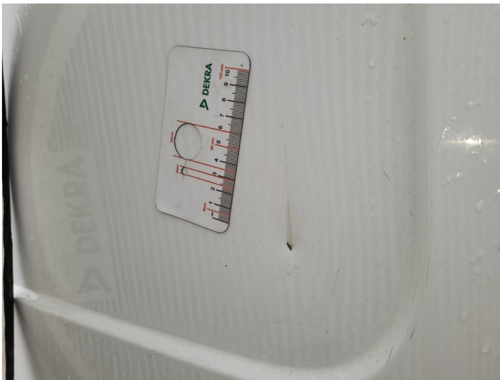
Vid' popis k poškodeniu č. 6
