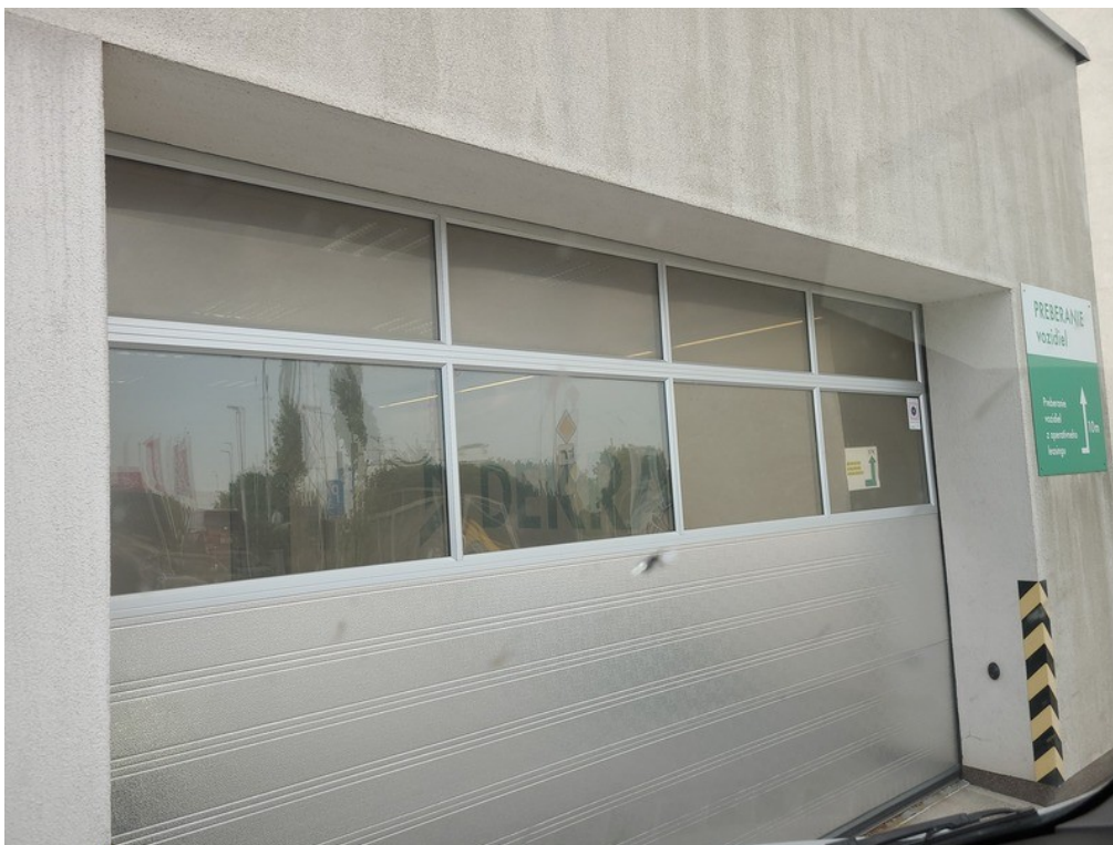
Vid' popis k poškodeniu č. 10
